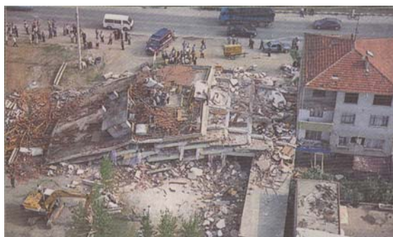
شکل ۱: نمونه‌ای از خرابی ساختمان بصورت پن کیک در زلزله ۱۹۹۹/ایزمیت
