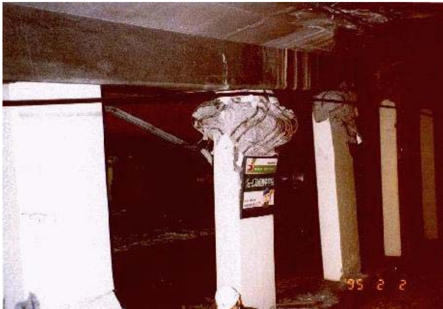
شکل ۲ نمایی از خرابی ستونهای میانی
