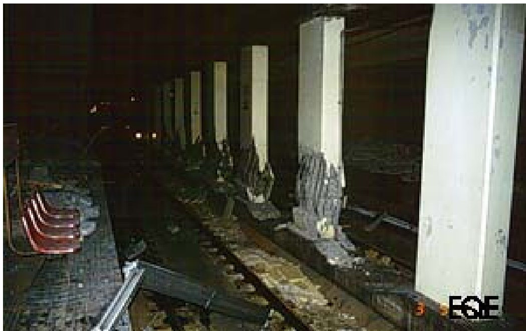
شکل ۳ نمایی از خرابی ستونهای میانی
